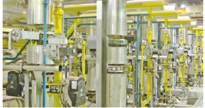
Hubbalkenofen mit Deckenbeheizung
