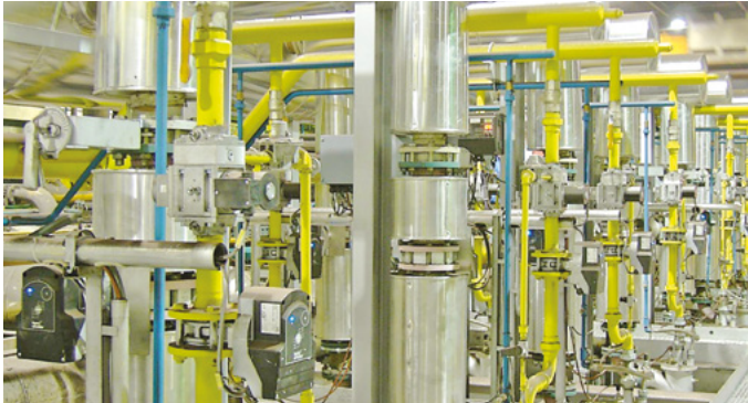
Hubbalkenofen mit Deckenbeheizung
