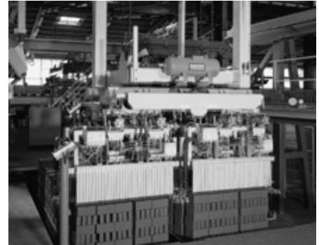
Edelstahlschläuche und -kompensatoren am Ofen in einer Ziegelbrennerei
